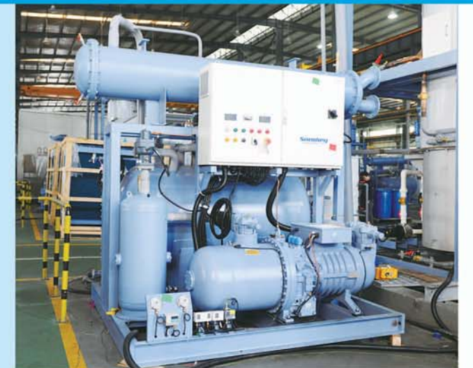
④ 管冰机压缩冷凝机组
