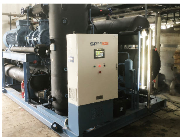
山东某印染热泵项目
