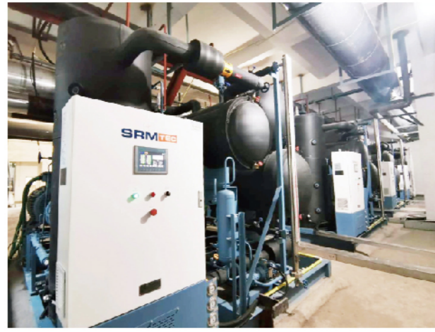
福建某化工热泵项目
