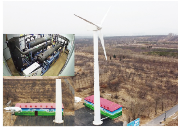
中科院风力氨热泵项目
