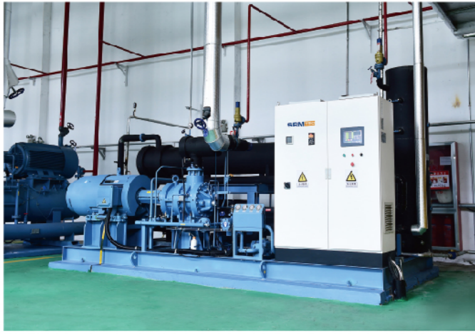
山东某食品热泵项目
